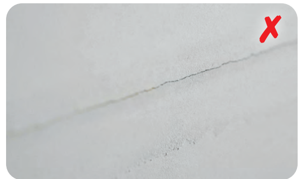
Fehler! Werden die Kanten nicht angefeuchtet, kommt es zum Aufbrennen der Spachtelmasse und zum Abriss in der Fuge.
