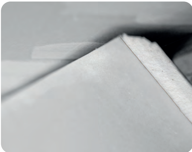
Ausgangssituation im Anschlussbereich zur Kehlbalckendecken.
