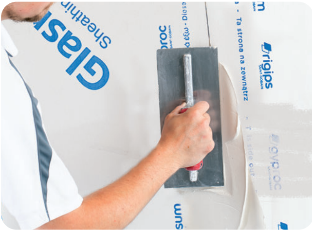
Die Längsfugen mit VARIO H Fugen- und Flächenspachtel quer zur Fuge verfüllen.
