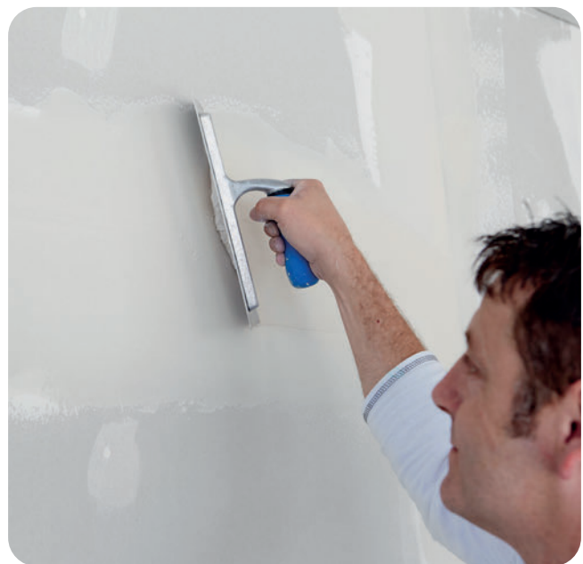
Zum Schluss wird mit nahezu anliegender Kelle mit einem geraden und schnellen Zug die Nachspachtelung mit den Quer- und Längsfugen geglättet. Mit dieser Nachspachtelung ist dann die Qualitätsstufe Q2 erreicht.
