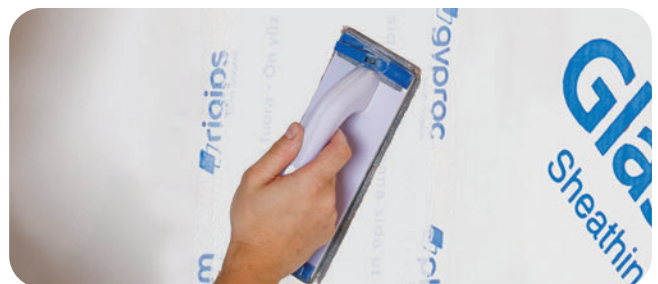
Nach ausreichender Trocknung erfolgt die Nachspachtelung mit dem VARIO H Fugen- und Flächenspachtel. Abhängig von der Anforderung der Oberflächenqualität kann noch ein Schleifen bzw. ein weiterer Überzug mit Spachtelmaterail bis zur Erreichung der geforder-ten Qualitätsstufe notwendig sein.
