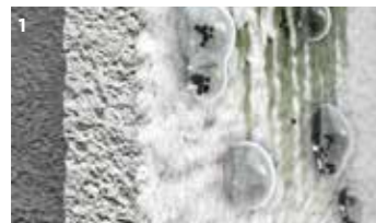
1: Bei herkömmlichen hydrophoben Putzen bleibt die Fassadenoberfläche lange feucht. Tauwasser und Regen sammeln sich in kleinen Putztaschen und verdunsten dort nur langsam.
