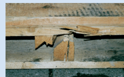
Kantholz angebrochen/ gebrochen
