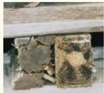
Zwei reparierte nebeneinanderliegende Kanthölzer (Abweichung von der Herstellernorm)
