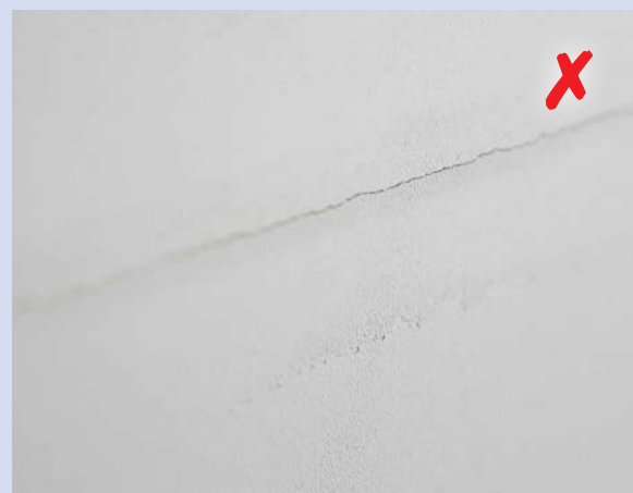
Fehler! Werden die Kanten nicht angefeuchtet, kommt es zum Aufbrennen der Spachtelmasse und zum Abriss in der Fuge.
