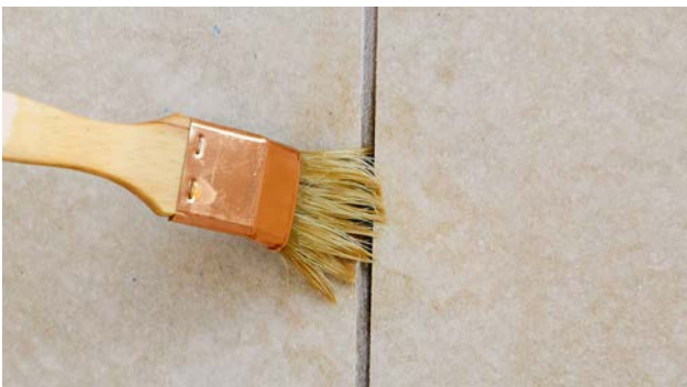
Der Abstand der montierten Platten beträgt ca. 5 bis 7 mm. Wichtig: Die Plattenkanten müssen entstaubt und vorgenässt werden.
