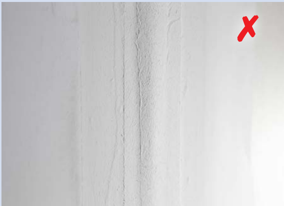
Überzieht man den Rigips Glasfaserbewehrungsstreifen nach dem Einlegen sofort mit weiterem Material kommt es zum Effekt des „Durchwalgens“, d.h., der Glasfaserbewehrungsstreifen fällt in der Mitte der Fuge nach außen aus und steht nach vorne vor.
