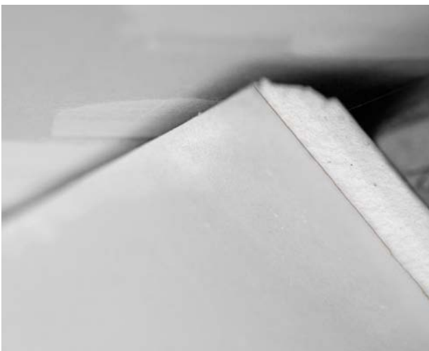
Ausgangssituation im Anschlussbereich zur Kehlbalkendecken.
